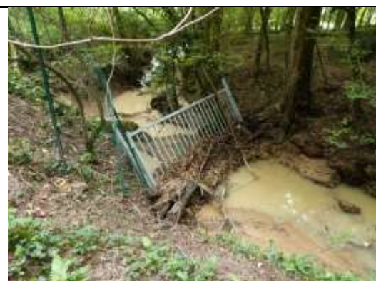
Figure 6 : Portail descellé par les embâcles transportés par les crues de l'hiver 2012
